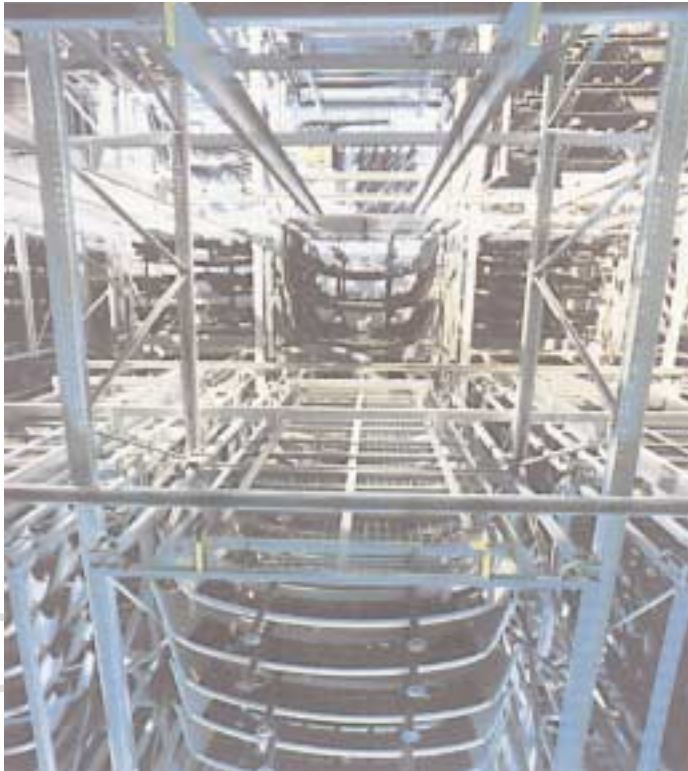
Abb. 2: 7,5 m tiefe Lagerkanäle für Kunststoff-Stoßfänger
