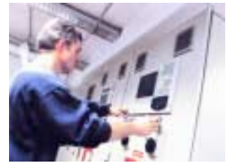
Sorgfältig wurden die Funktionen der Lagersteuerung und des LVS aufeinander abgestimmt.
